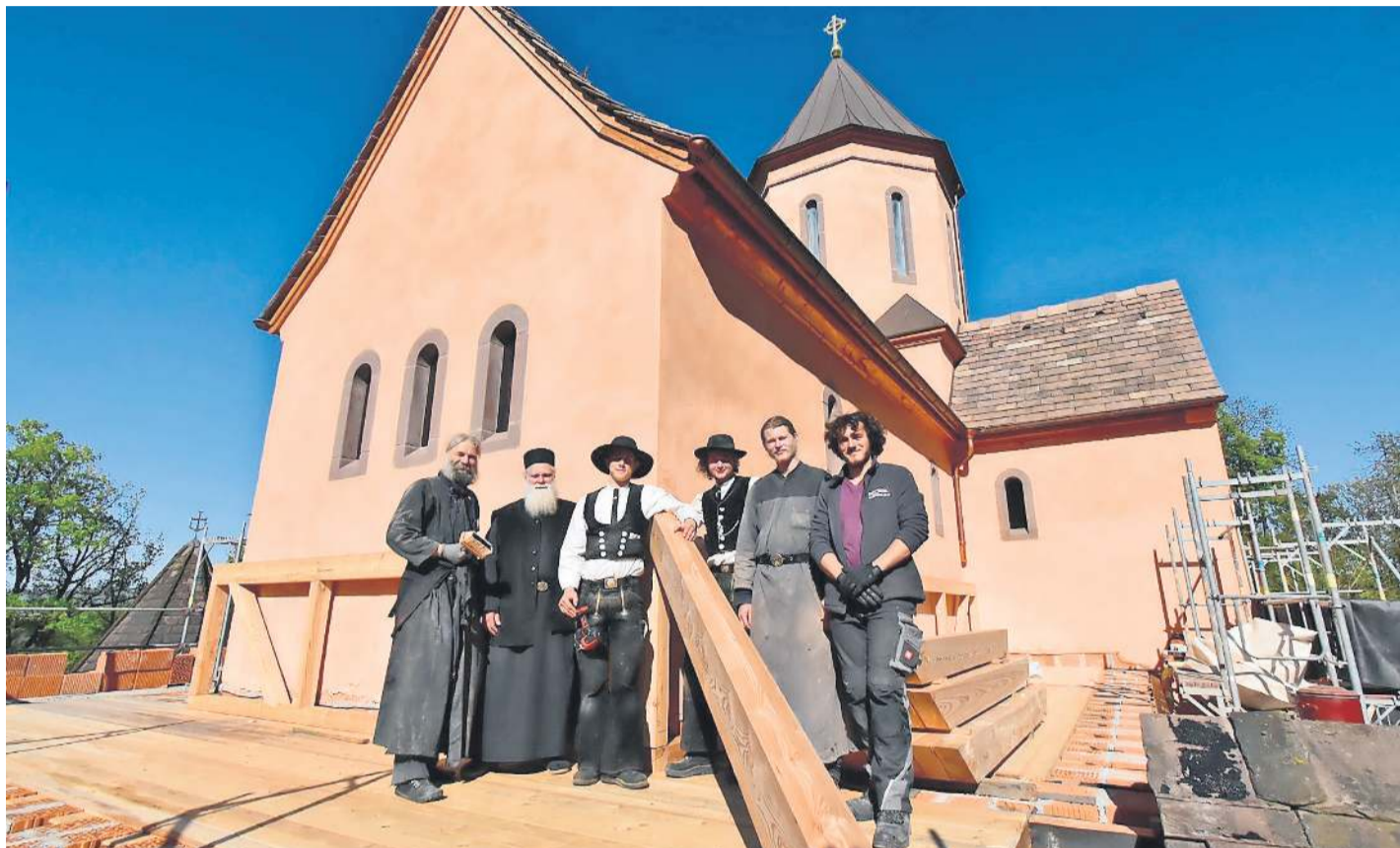
Die Mönche des Klosters und zwei Wandergesellen haben die Vorbereitungen am Kirchendach weitestgehend abgeschlossen, so dass das Dach demnächst eingedeckt werden kann.
